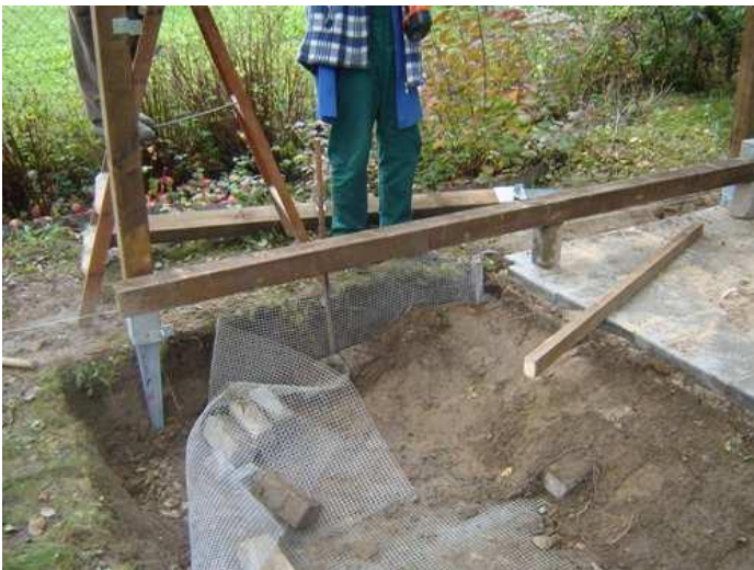
Boden mit einer Einschlaghülse und erster Querbalken von Rahmenkonstruktion in einer Hülse. Der Balken liegt noch leicht schräg, da die mittlere Einschlaghülse noch fehlt.
